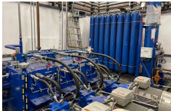
Potrubní rozvody různých médií
